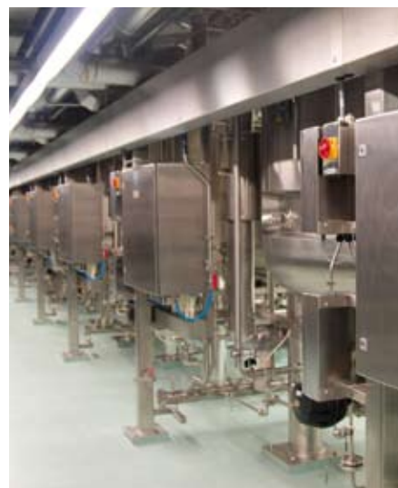
Die Anlage ist mit 200 anschlussfertigen Schaltschränken bestückt.
