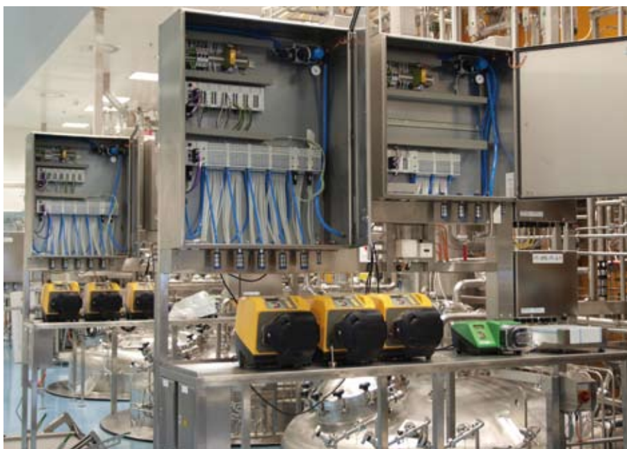
Komplettlösung Schaltschrank: Kernstück der Automatisierung auf der Sensor-Aktor-Ebene ist die CPX/MPA-Ventilinsel. Dank ihres flexiblen Steuerungskonzepts sind an der busangesteuerten Ventilinsel als E/A-Baugruppe alle nicht Fieldbus Foundation-fähigen Signale und Prozessventile angeschlossen.
