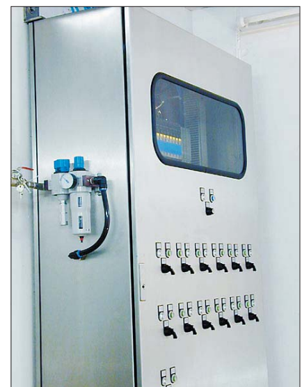
Ilustracja 4. Wyspa zaworowa w szafce sterowniczej z wygodnym poziomem obsługi ręcznej
