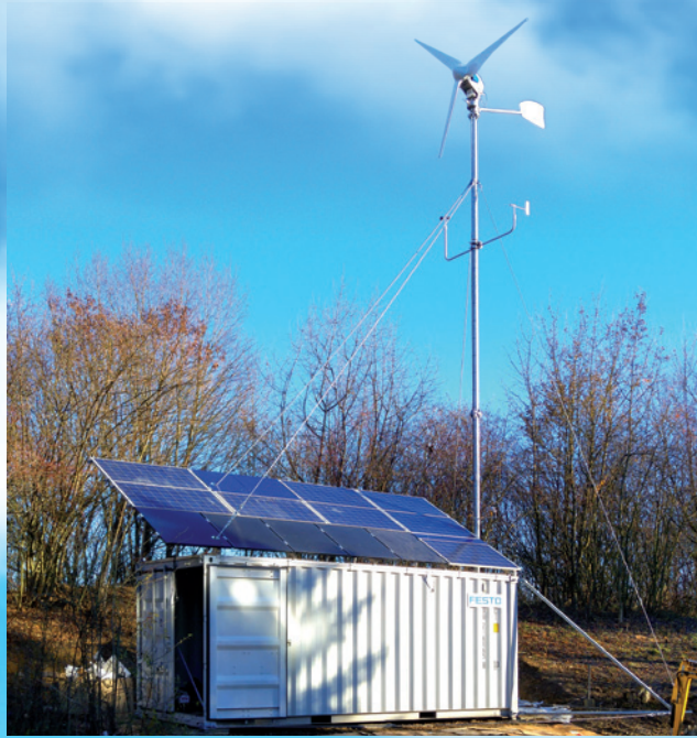
Ende 2016 erfolgte die Inbetriebnahme eines EDS Energy Cubes bei der Gewerblichen Schule in Göppingen (D).
