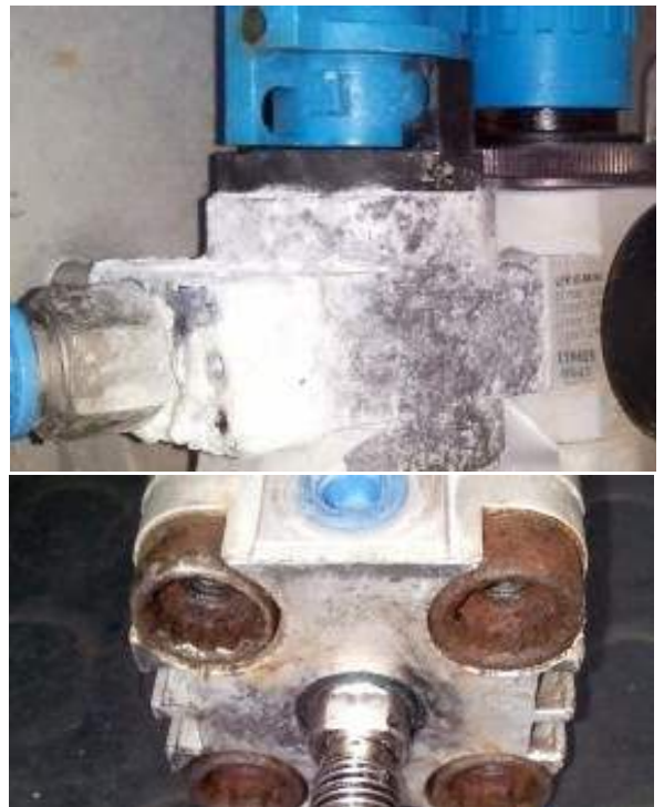
Mala elección del material: daños habituales
