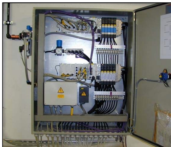
Fig. 10: armario de maniobra con terminal de válvulas.
