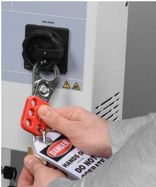
Figure 8 : Installation d'un morillon de verrouillage, d'un cadenas et d'une étiquette.
