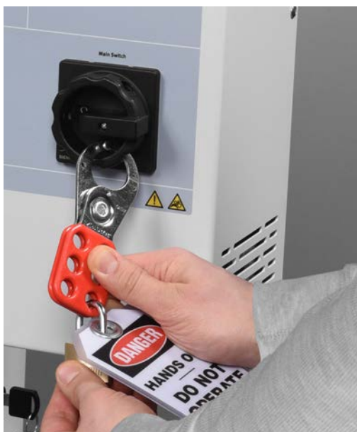
Rysunek 8: Instalacja zasuwy blokującej, kłódki i przywieszki.
