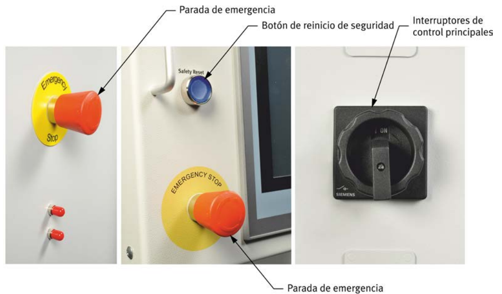
Figura 13: Interruptores de control principales.
