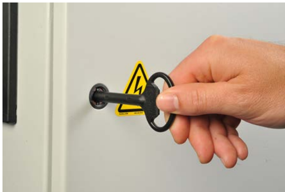
Figura 35: Bloquee la puerta del panel eléctrico para evitar el acceso no autorizado.
