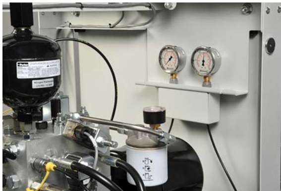
Figura 36: Resguardos de protección de los manómetros.
