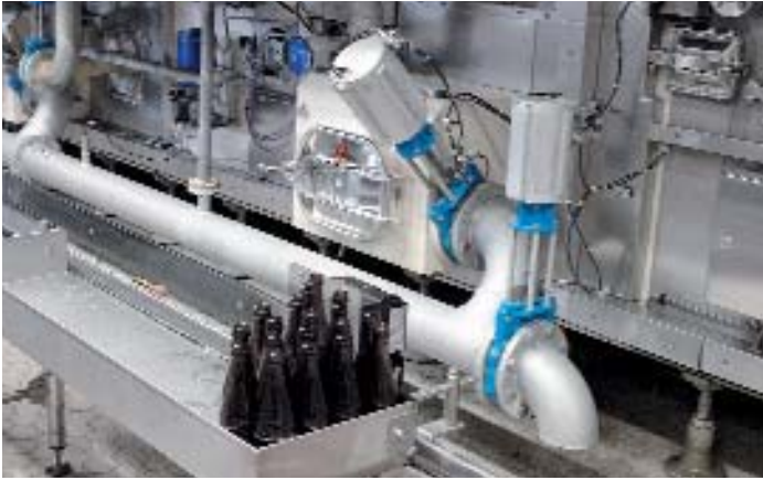
Los actuadores para procesos de Festo del tipo DLP son los encargados en la instalación de lavado de botellas Innoclean de KHS de abrir y cerrar las trampillas de los conductos de alimentación de lejía para el lavado
