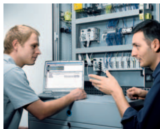
Optimisation du paramétrage lors de la mise en service
