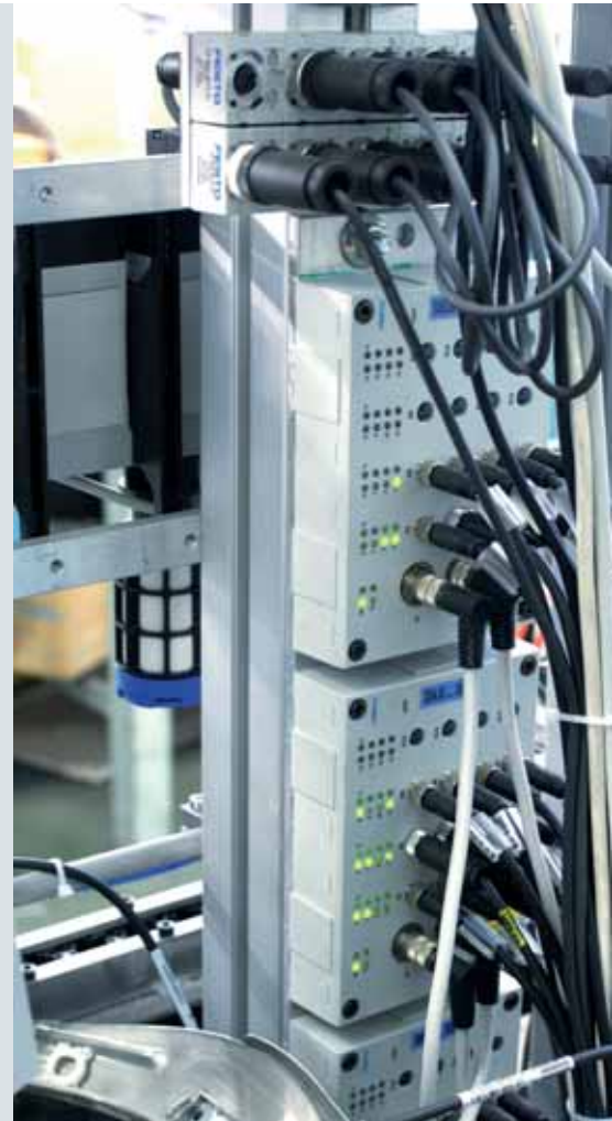
Die Sensordaten werden über das CPI-Bus-system an die Steuerung weitergeleitet.
