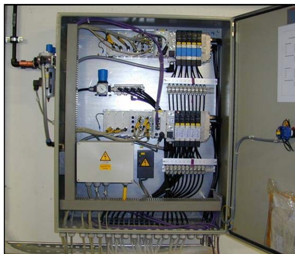
Abbildung 10: Schaltschrank mit Ventilinsel.
