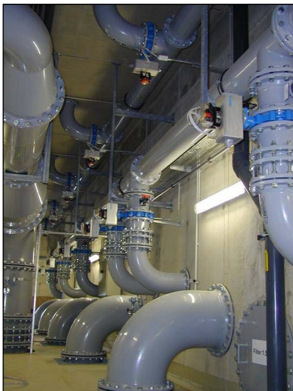
Abbildung 8: Rohr Keller in einer Wasseraufbereitungsanlage.
