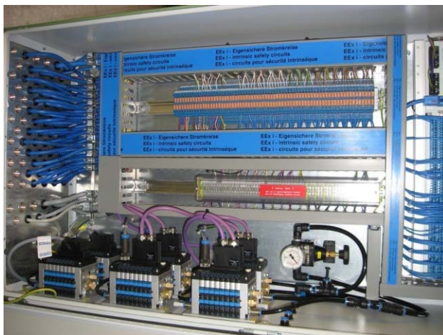
Abbildung 14: Ventilinselschrank in ATEX Zone 2 mit Ventilen für die PLT Schutzeinrichtung.
