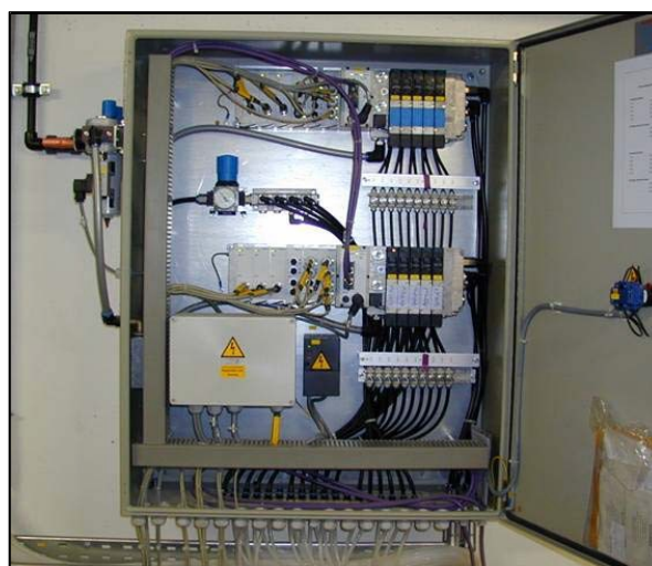
Fig. 10: armario de maniobra con terminal de válvulas.
