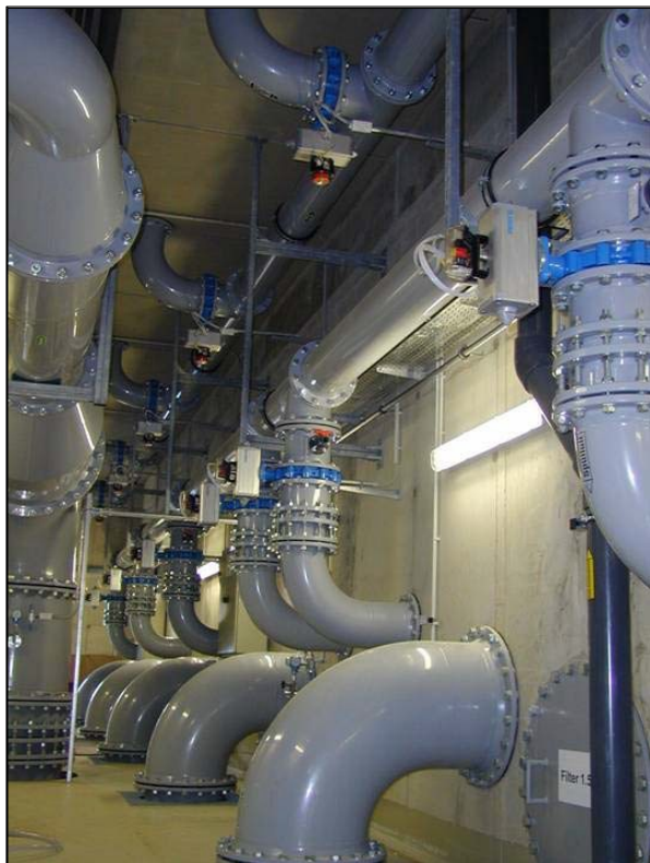
Fig. 8: tuberías en la planta inferior de una planta de tratamiento de aguas residuales.
