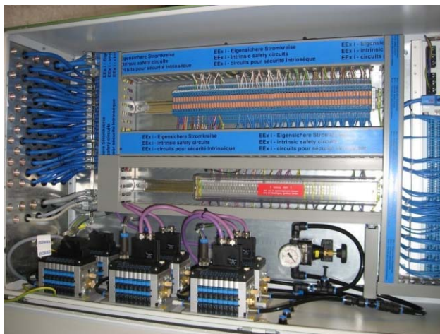
Fig. 14: armario de maniobra para zona ATEX 2, con válvulas para el dispositivo de protección PLT.
