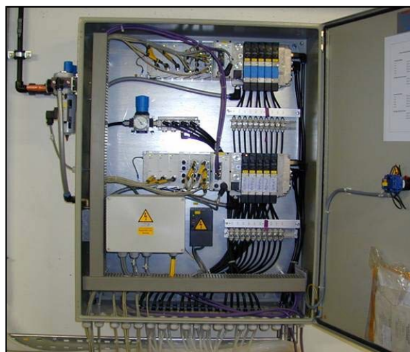
Figura 10: painéis de comando com terminal de válvulas.
