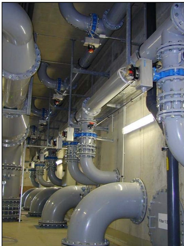
Figura 8: local onde ficam as tubulações em uma estação de tratamento de água.
