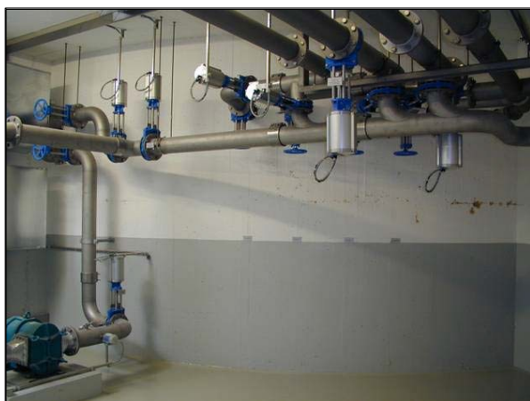
Figura 9: local onde ficam as tubulações em uma estação de tratamento de esgoto.
