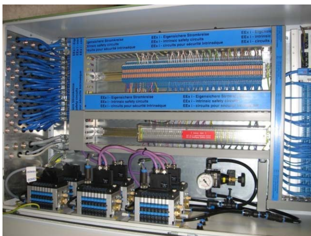
Figura 14: armário do terminal de válvulas na ATEX Zona 2 com válvulas para dispositivo de proteção PLT.
