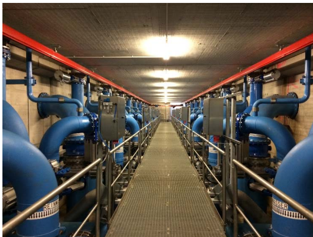
Abb. 2: Rohrkeller mit Armaturen und Schaltschränken
