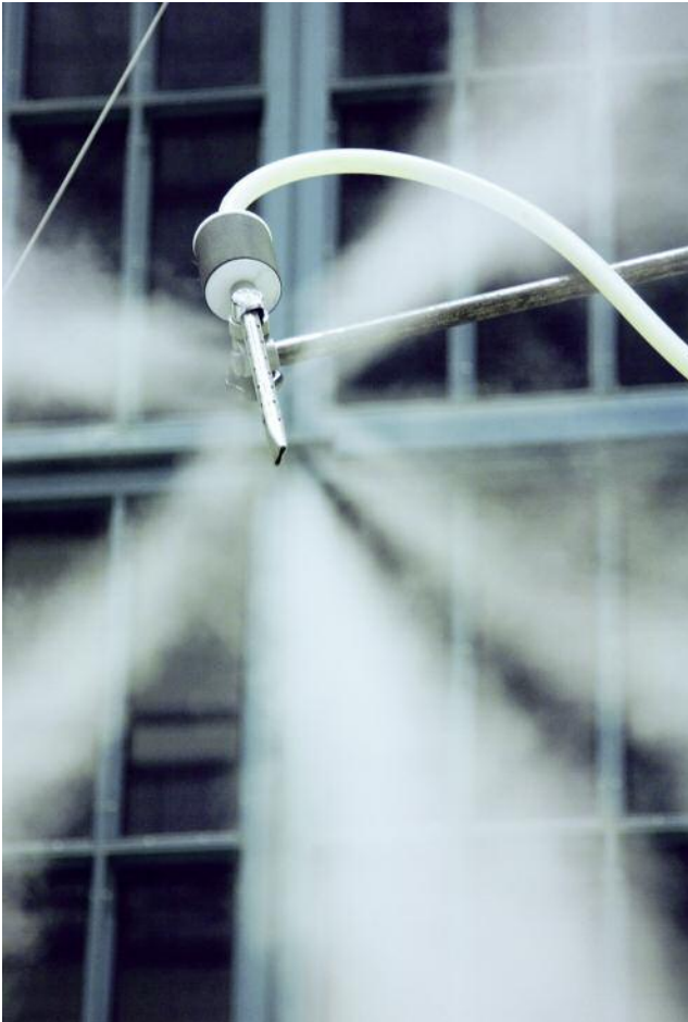
Dampfaustritt am Diffusor. Erst durch Kondensation wird der Dampf sichtbar.
