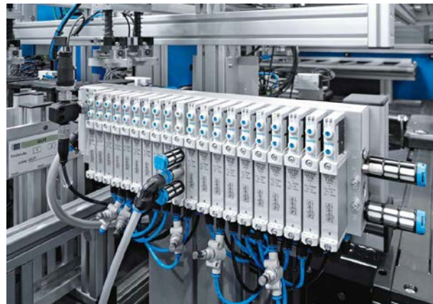
Eine VTUG Ventilinsel steuert alle pneumatischen Aktoren der Anlage, verbunden per IO-Link mit der Master-Steuerung.
