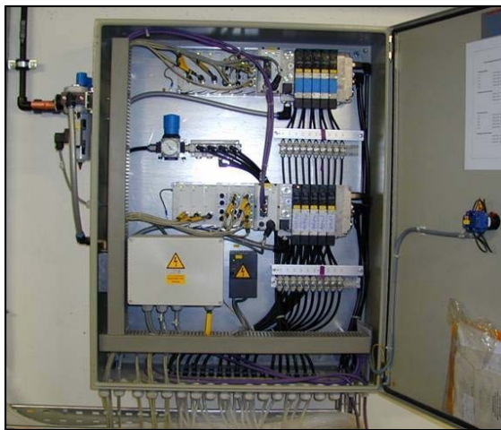
Figure 10 : armoire de commande avec terminal de distributeurs.
