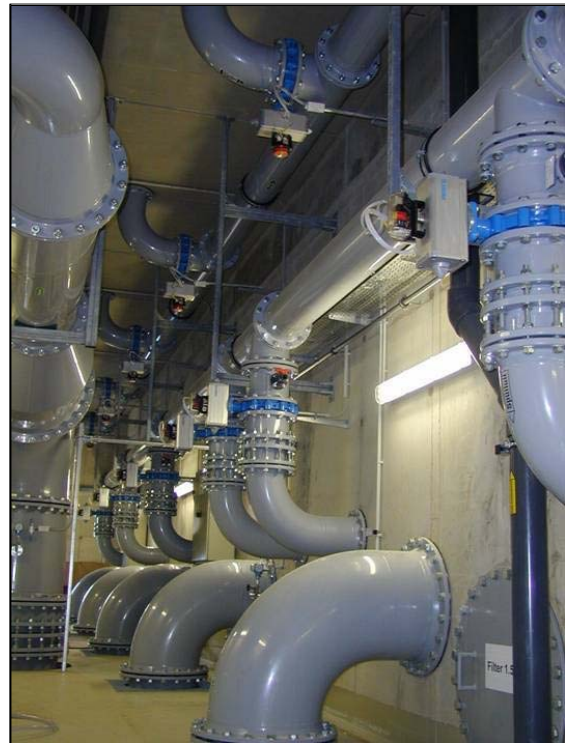
Figure 8 : cave de tuyauterie dans une station d'épuration.
