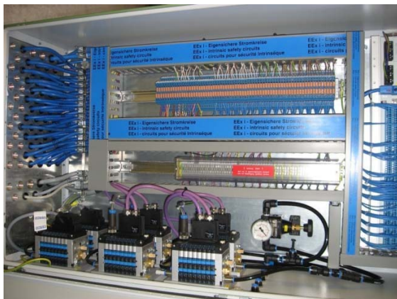
Figure 14 : armoire de terminaux en zone ATEX 2 avec distributeurs pour le dispositif de protection PLT.
