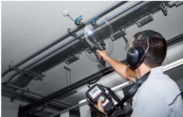
Abbildung 10: Ortung von Leckagen in der Druckluftverteilung
