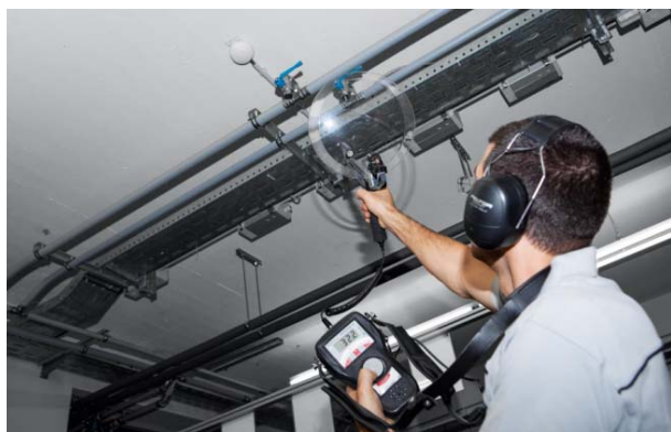
Abbildung 10: Ortung von Leckagen in der Druckluftverteilung
