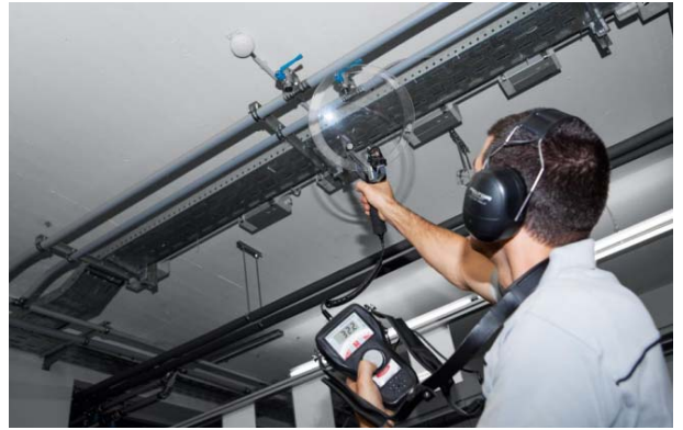
Figura 9: Localización de fugas en la distribución de aire comprimido
