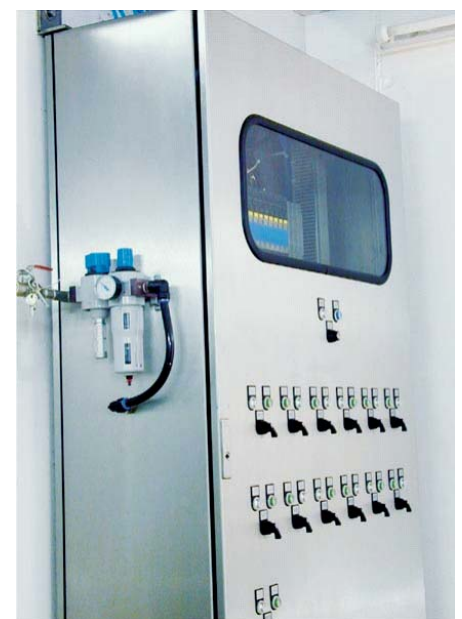
Bild 4: Ventilinsel im Schaltschrank mit komfortabler Handbedienebene
