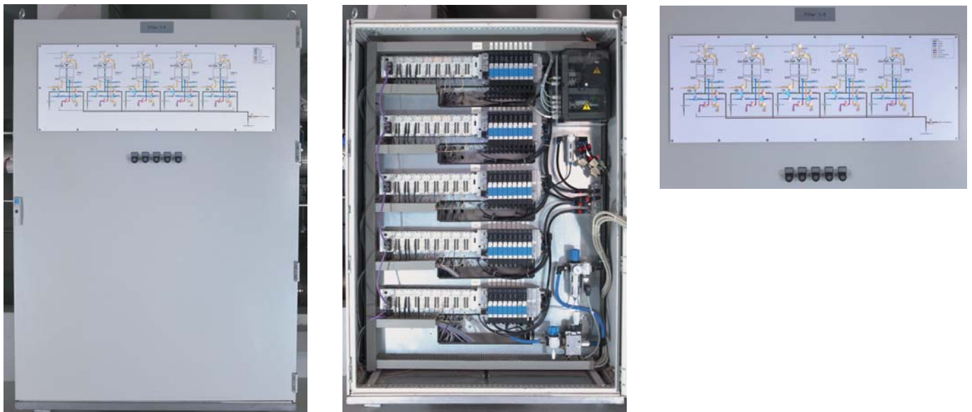
Bild 5: Ventilinsel im Schaltschrank mit Anlagenschema Fig. 5: Valve terminal in control cabinet with schematic plant diagram
