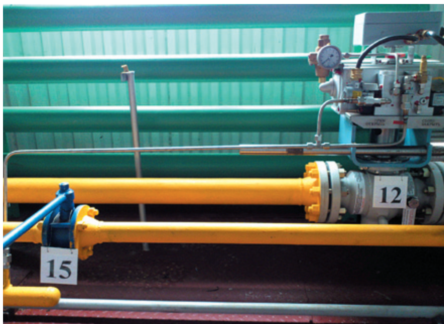
Централизованный сбор выхлопа газа на свечу (установка в помещении)
